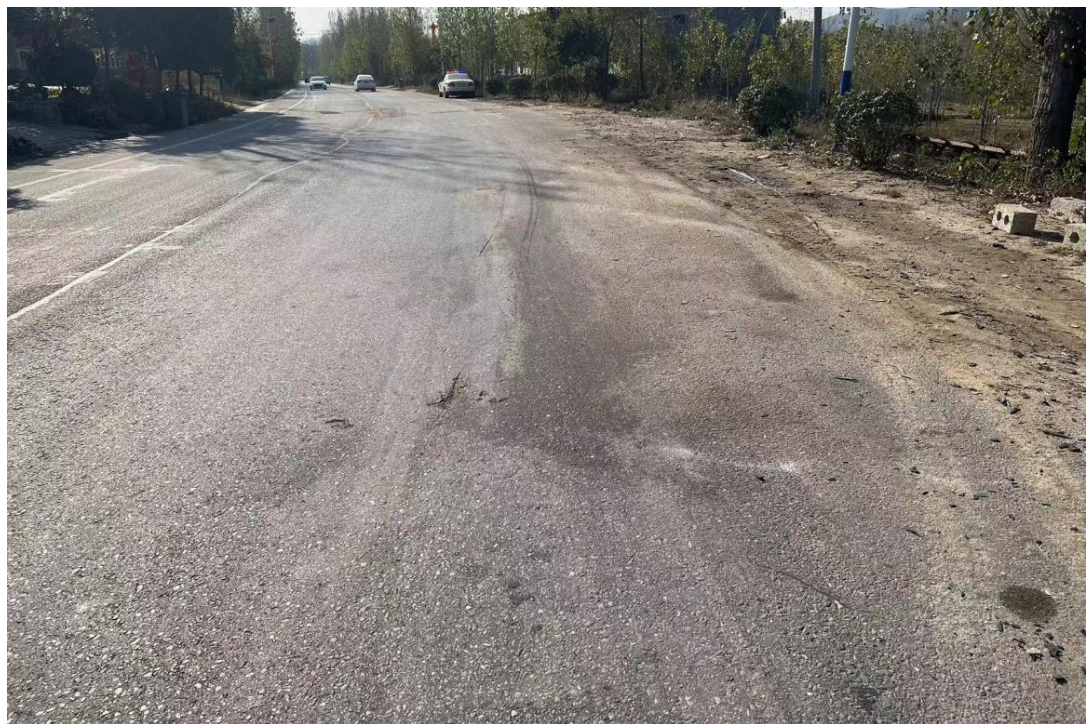
图 2：事故现场照片（自南向北拍摄）
